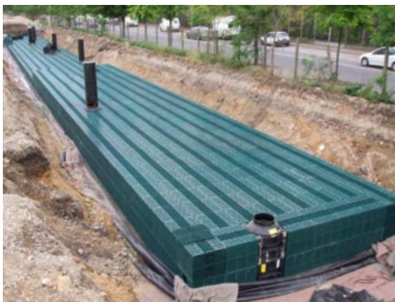
Bassin enterré à structure alvéolaire
